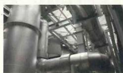
プラント配管
