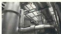
プラント配管
